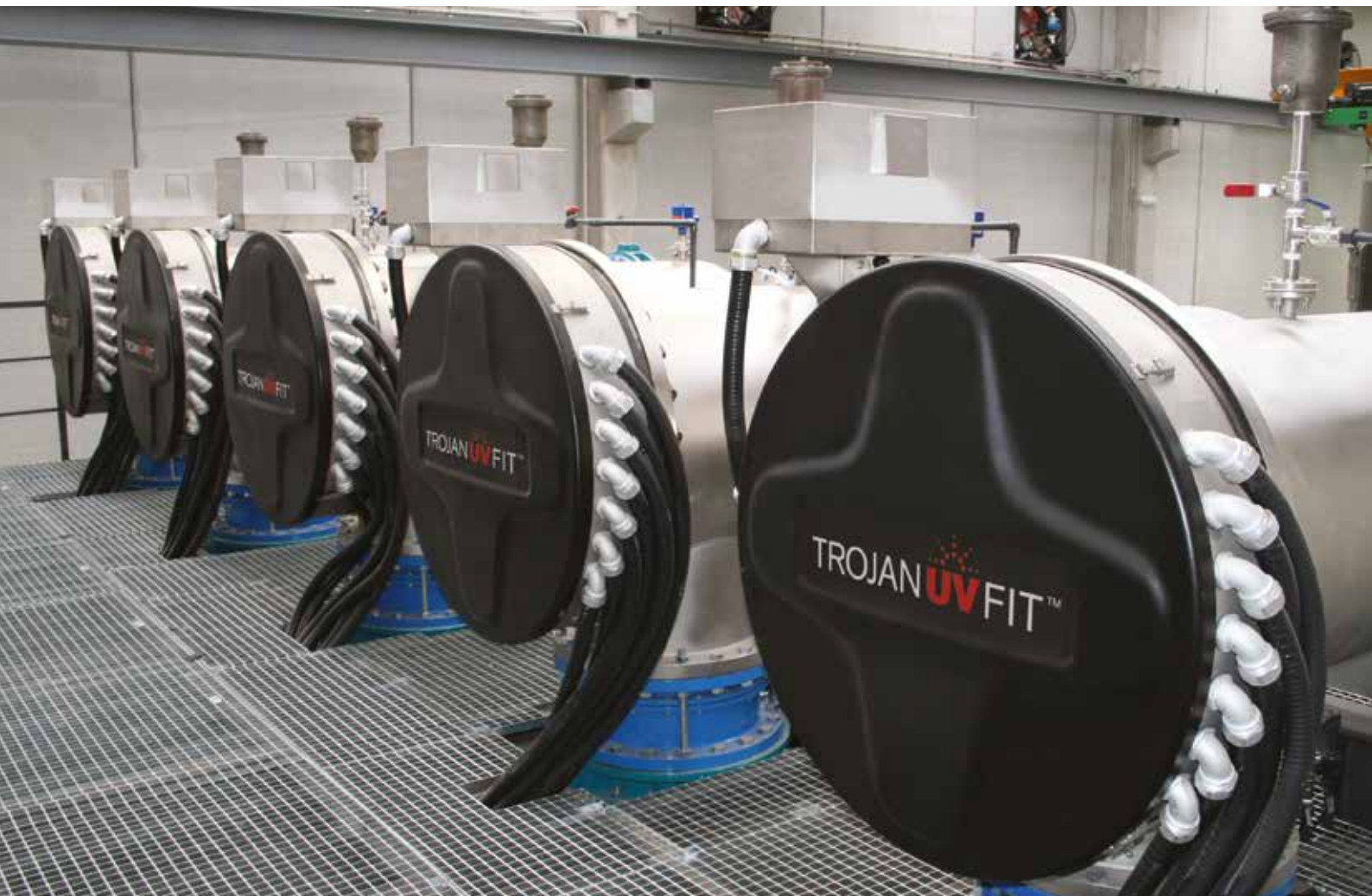
TRAITEMENT PAR REACTEURS FERMES DES EAUX RESIDUAIRES FILTRES
