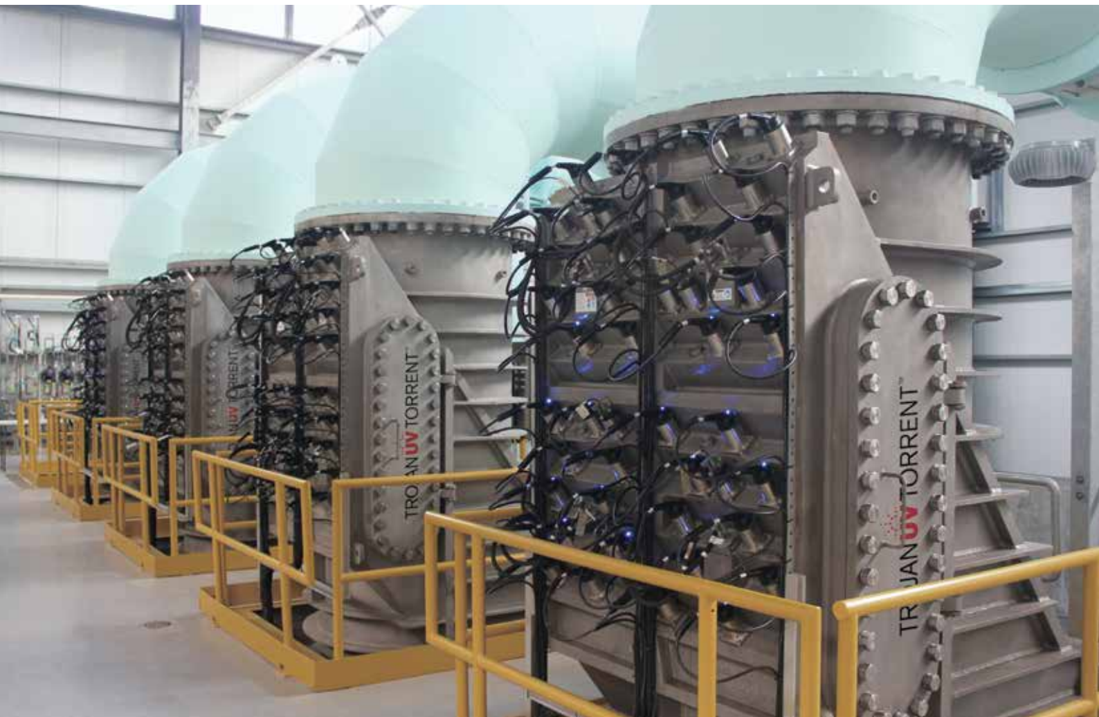
TRATTAMENTO DELL'ACQUA POTABILE
